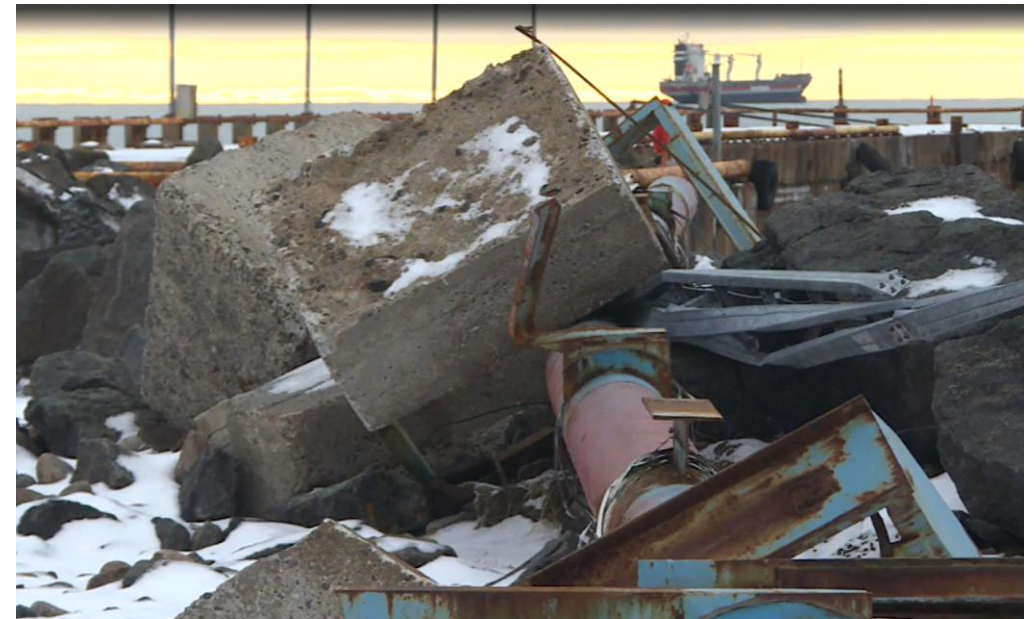
Dégâts au quai municipal de Port-Cartier
